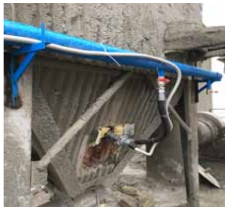
Рис. 5. Фрагмент системы пульсирующих форсунок на одном из бункеров аспирационных фильтров на цементном заводе 2
