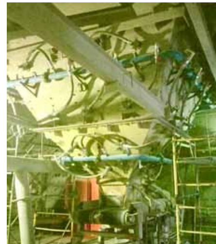
Рис. 3. Бункер гипсосодержащих добавок с системой пульсирующих форсунок на цементном заводе 1
